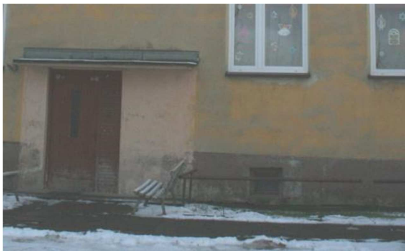
Rys. nr 7. Korozja obróbek blacharskich, ubytki tynku i zawilgocenia ścian ścian przyziemia. [1.4].
