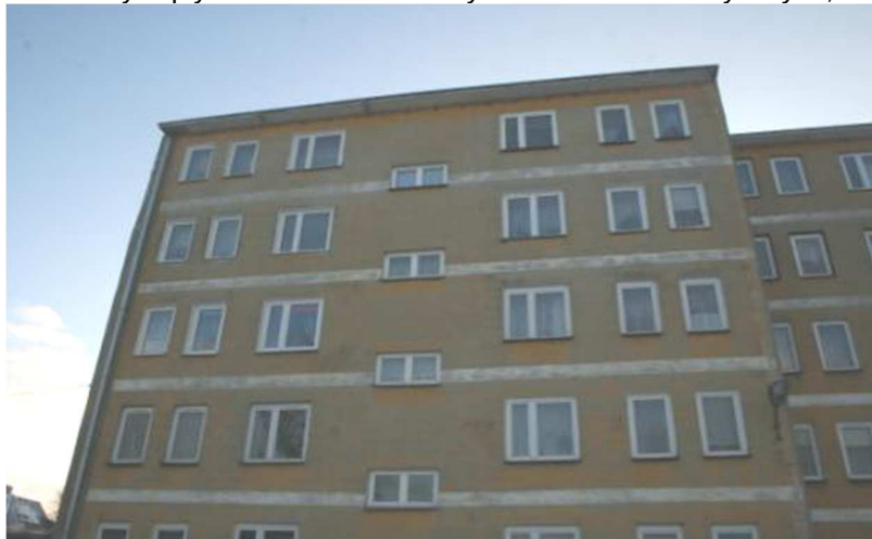
Rys. nr 5. Lokalne przebarwienia i zabrudzenia powierzchni elewacji, korozja elementów metalowych – rur spustowych, ogniska korozji biologicznej. [1.4.].
