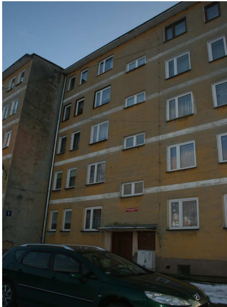
Rys. nr 6. Przebarwienia elewacji szczytowych i podłużnych. [1.4.].
