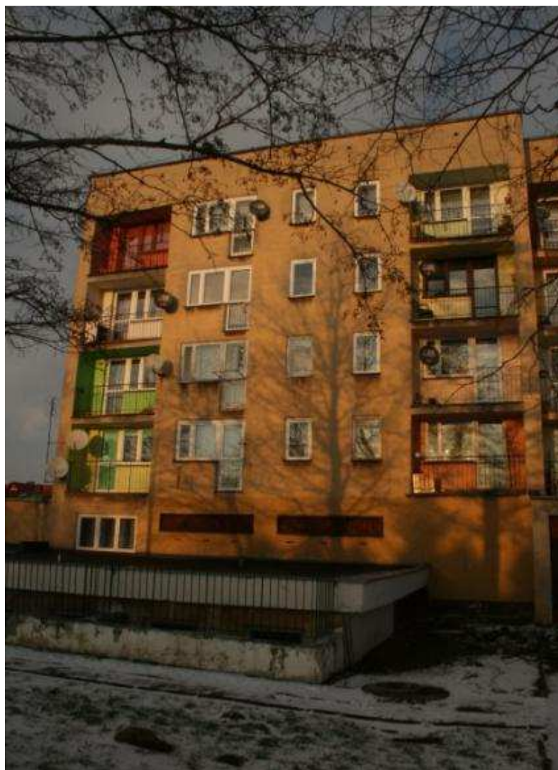
Rys. nr 8. Korozja obróbek blacharskich, ubytki tynku i zawilgocenia ścian murku oporowego, brak wymaganej wysokości balustrady. [1.4].
