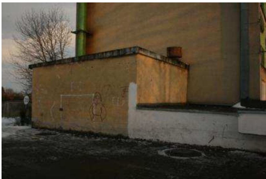
Rys. nr 7. Znaczna korozja elementów metalowych – obróbkę blacharskich, drabinki przy kominie, zniszczona elewacja kotłowni [1.4].
