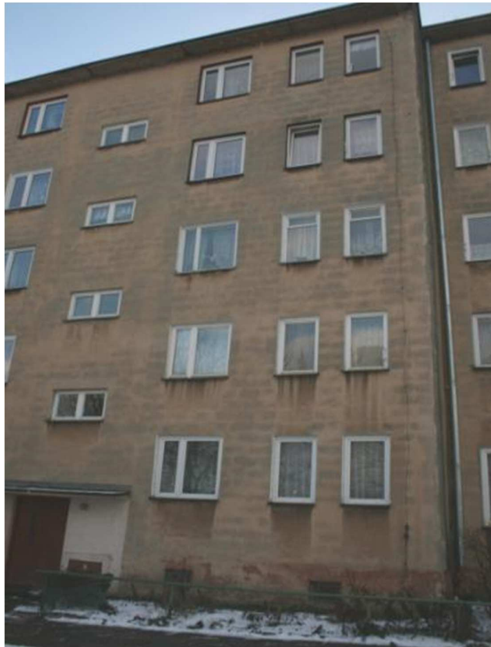
Rys. nr 5. Lokalne przebarwienia i zabrudzenia powierzchni elewacji, korozja elementów metalowych – rur spustowych, ogniska korozji biologicznej, łuszczenie i odpadanie farby ze ścian przyziemia. [1.4].
