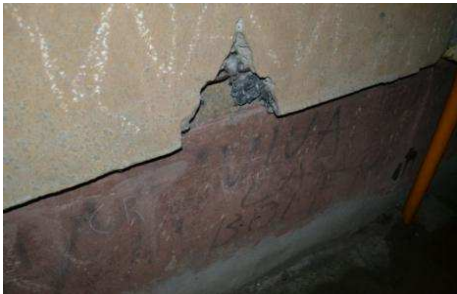
Rys. nr 6. Lokalne ubytki płyt wiórowo - cementowych - elewacja szczytowa. [1.4].
