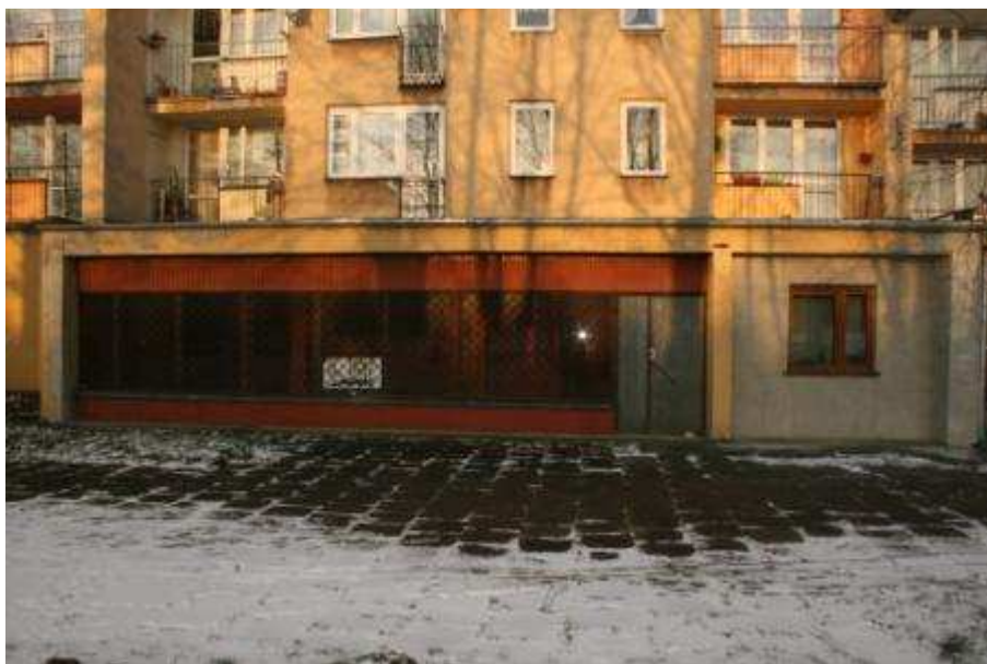
Rys. nr 9. Korozja obróbek blacharskich, znacznie wyeksploatowana stolarka i ślusarka okienna i drzwiowa lokalu użytkowego. [1.4].
