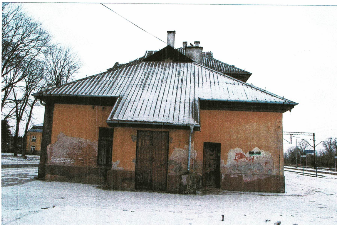
Fot.5. Dworzec Kolejowy w Charsznicy z1885 r. Stan zachowania przed konserwacją. Elewacja północna. Widoczne ubytki zaprawy , wysolenia i pudrowanie się cegły. Luty 2017 r. Fot. Tadeusz Sokal
