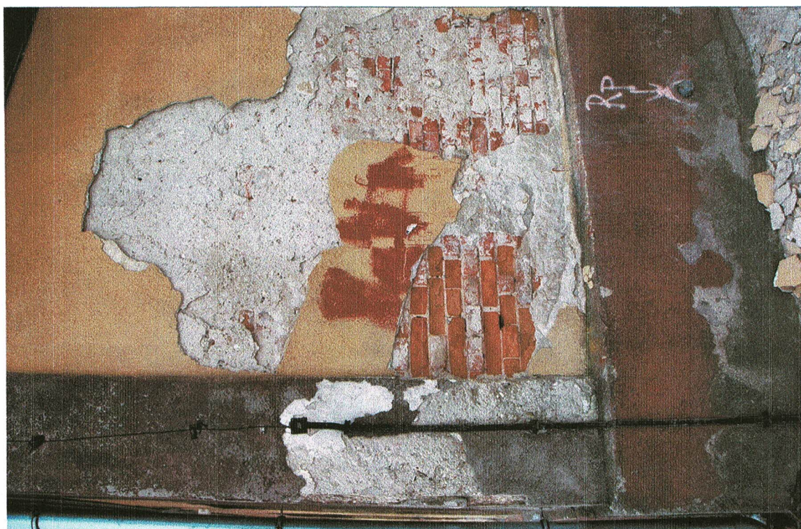
Fot.14 Dworzec Kolejowy w Charsznicy z1885 r. Stan zachowania przed konserwacją. Elewacja południowa. Fragment ściany z osypującym się tynkiem, widać proces pudrowania się cegły.
