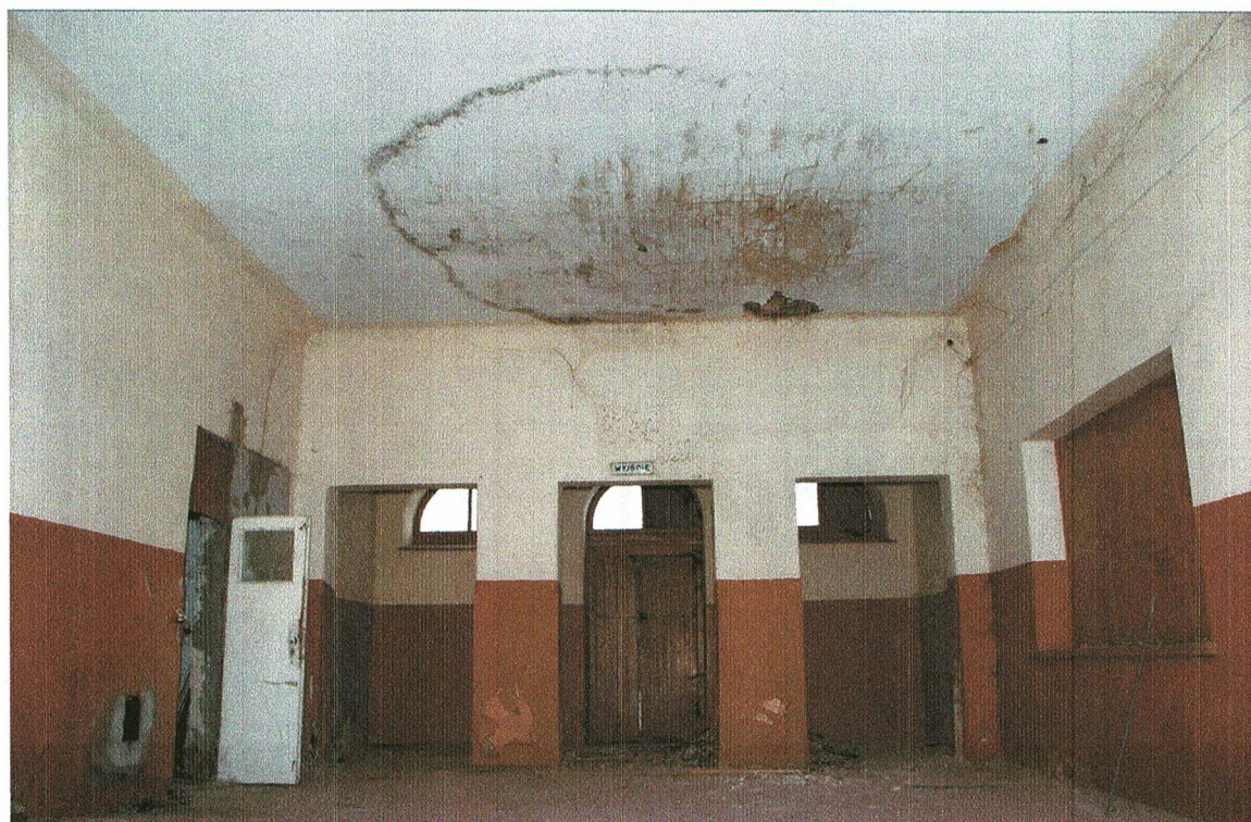
Fot.8. Dworzec Kolejowy w Charsznicy z1885 r. Stan zachowania przed konserwacją. Hol główny dworca. Widoczne rozległe zacieki na suficie. Luty 2017 r. Fot. Tadeusz Sokal
