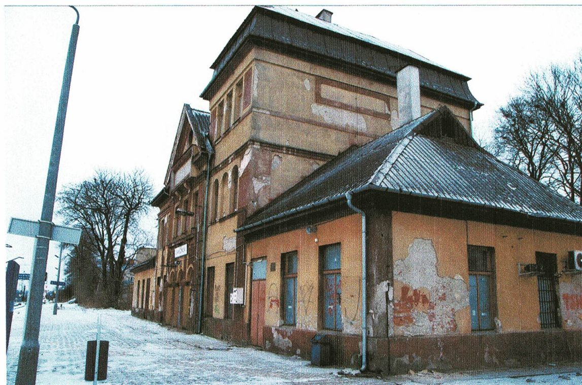
Fot.6. Dworzec Kolejowy w Charsznicy z1885 r. Stan zachowania przed konserwacją. Elewacja południowo-zachodnia. Widok rozległych ubytków tynku, wiszące kable na elewacji od strony peronów. Luty 2017 r. Fot. Tadeusz Sokal
