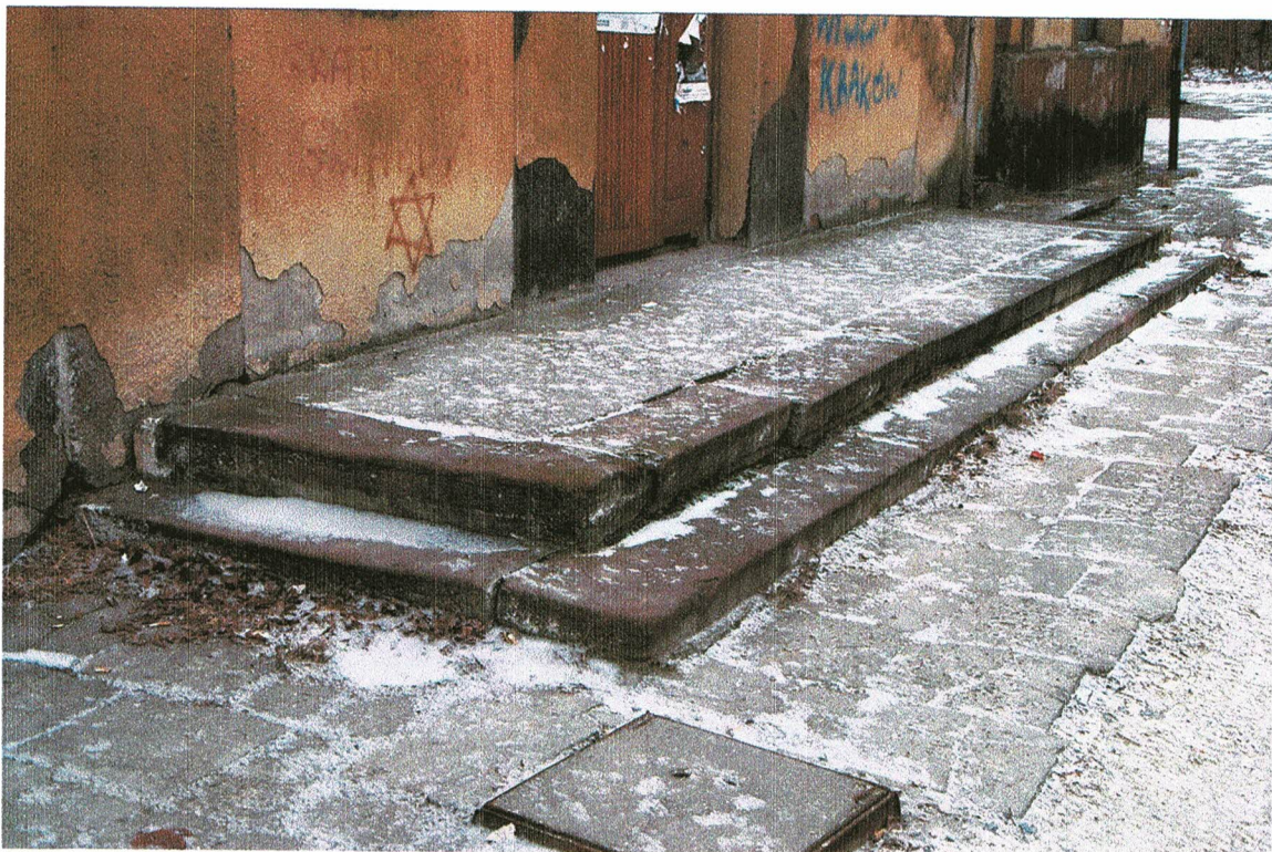
Fot.11 Dworzec Kolejowy w Charsznicy z1885 r. Stan zachowania przed konserwacją Elewacja wschodnia od strony ul. Kolejowej. Widok kamiennych stopni prowadzących do wnętrza dworca . Luty 2017 r. Fot. Tadeusz Sokal
